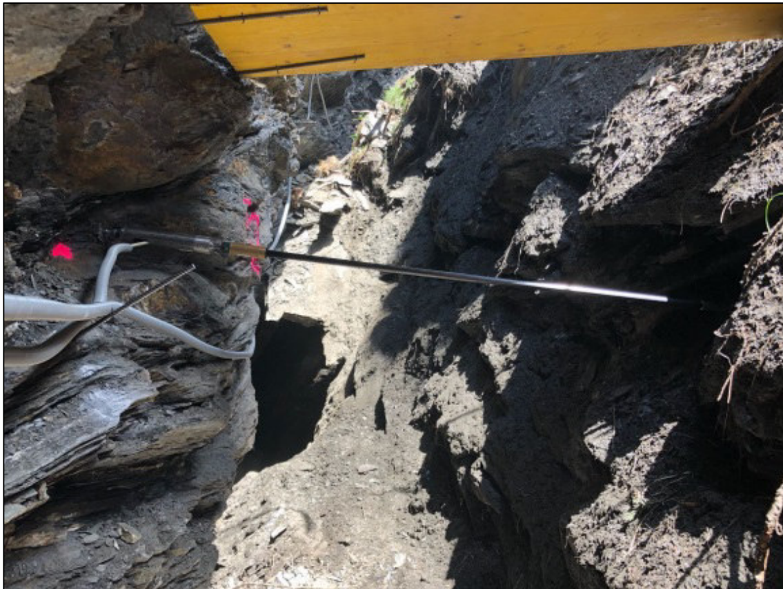
Abbildung 8: eingebauter Extensometer S3
