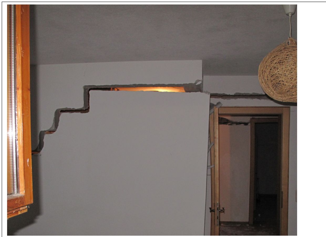
Abb. 2: Die Folgen des Erdalles waren Risse in sämtlichen Räumlichkeiten des Hauses, das abgebrochen werden musste.
